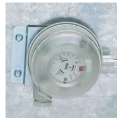
Presostato ubicado en el interior de la caja.
