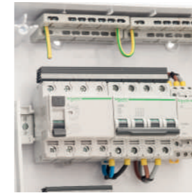
Amplio espacio para el cableado Wide space for the cabling
