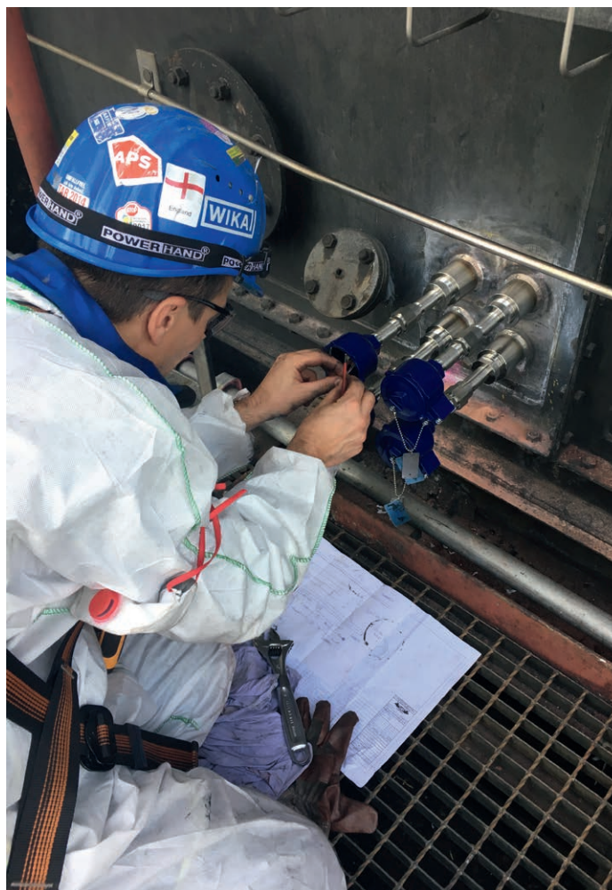
Transmisión de señales y prueba de funcionamiento
