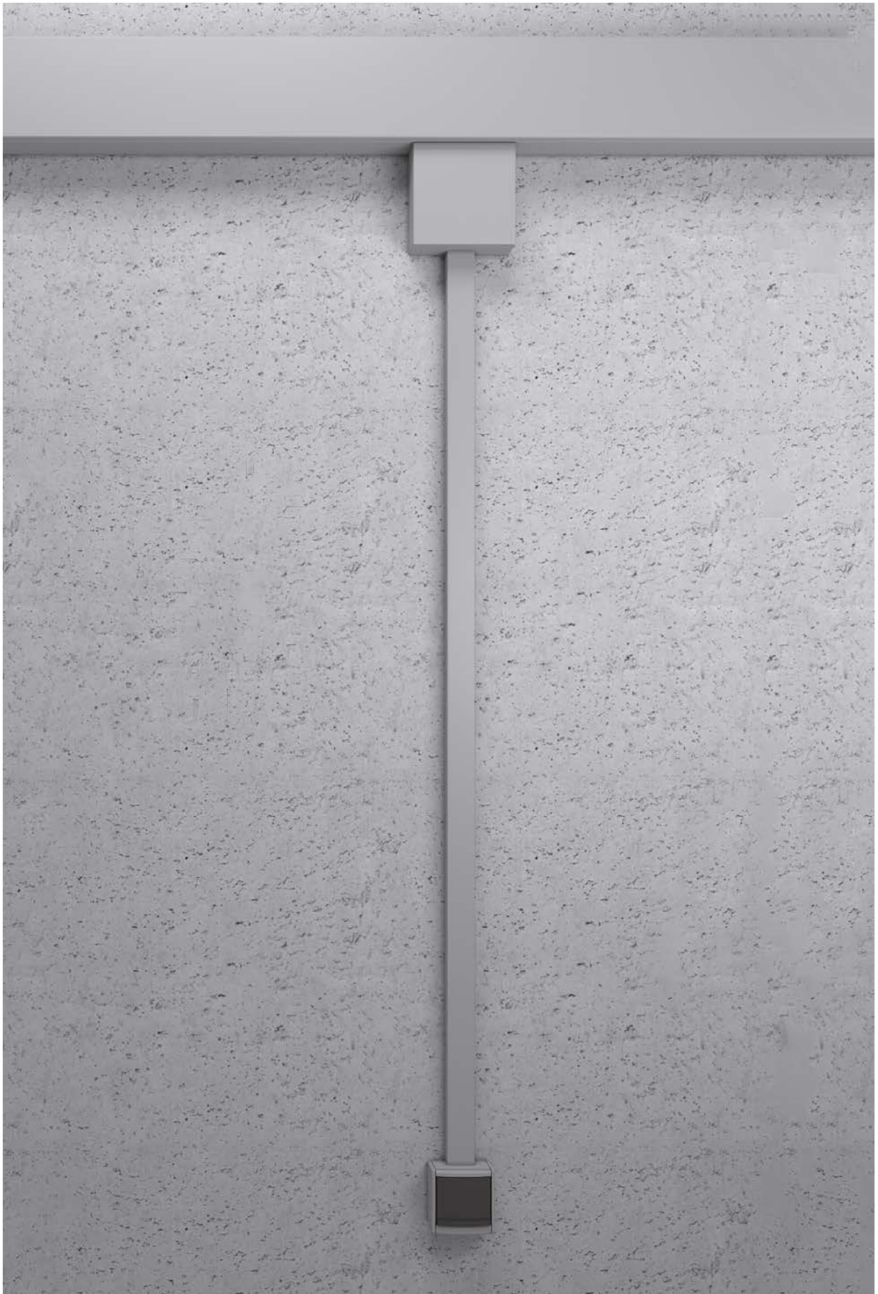
Nave industrial: alimentación de mecanismos
