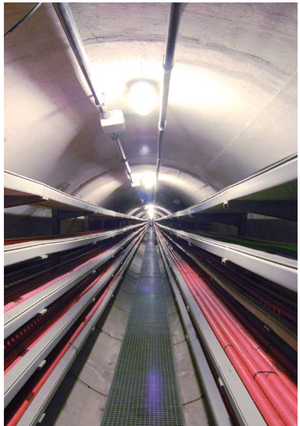
Aeropuerto: galería técnica
