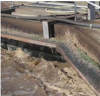
Resistencia a la corrosión
