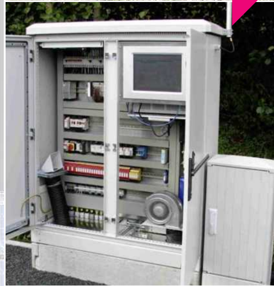
Armarios de distribución
